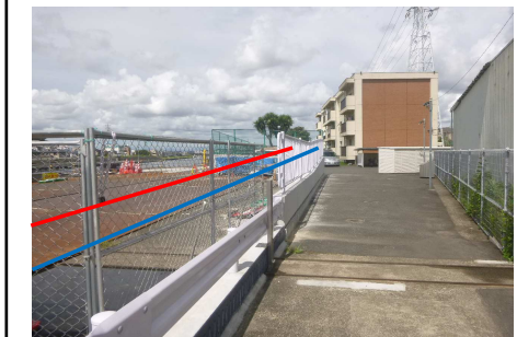
⑥敷地入り口 (橋梁の掛け替え工事で敷地の一部を貸与)
