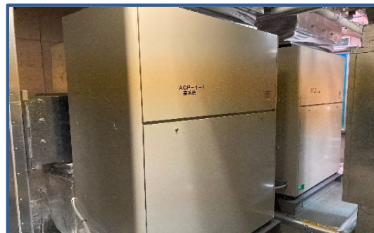
空気調和機設置状況
