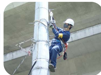
テレメータ設置
