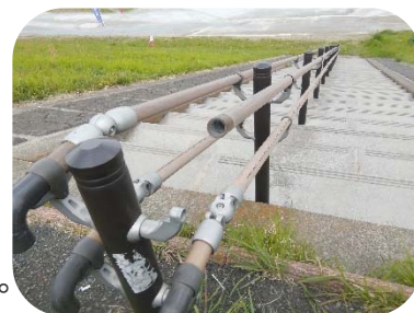
手すりの破損を確認
