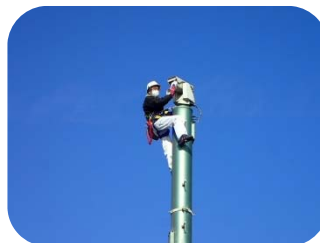
監視カメラ（CCTV）
