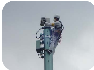
監視カメラ（CCTV）
