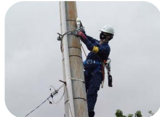
テレメータ設置
