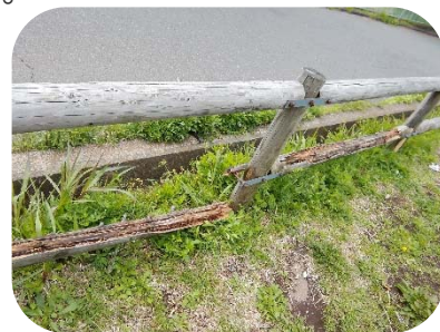
手すりの破損を確認
