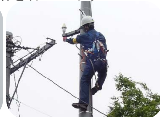
テレメータ設置
