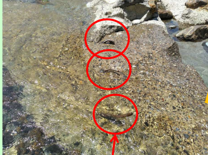
構造物の一部で鉄筋が露出
