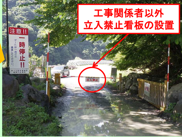
看板表示により、一般車両の進入を防ぐ。
