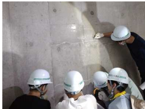
橋梁箱桁内部のひび割れ調査
