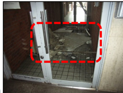
落下した天井材
