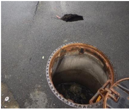
老朽管の破損による道路の 陥没
