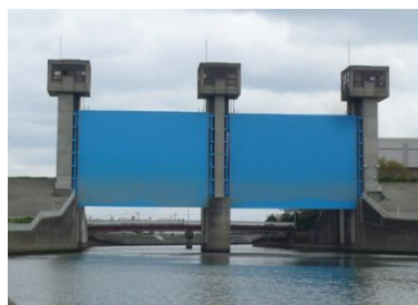
写真-2 ゲート設備
