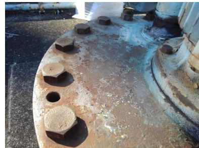
写真-5 発錆状況
