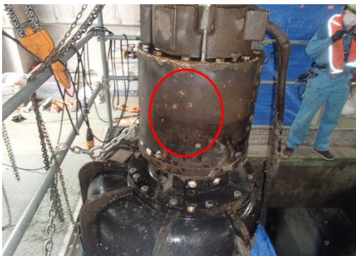
写真-9 腐食孔発生状況 (赤枠内に腐食孔発生)
