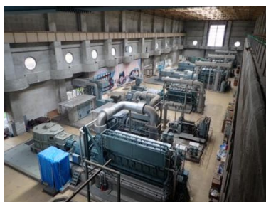
写真-1 ポンプ設備
