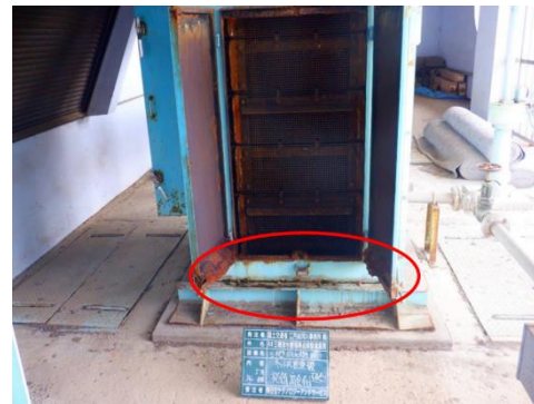
写真-12 欠損発生状況 (赤枠内に欠損発生)
