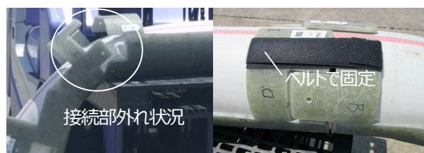
図-7 接続部外れ状況(左)及び対策(右)
