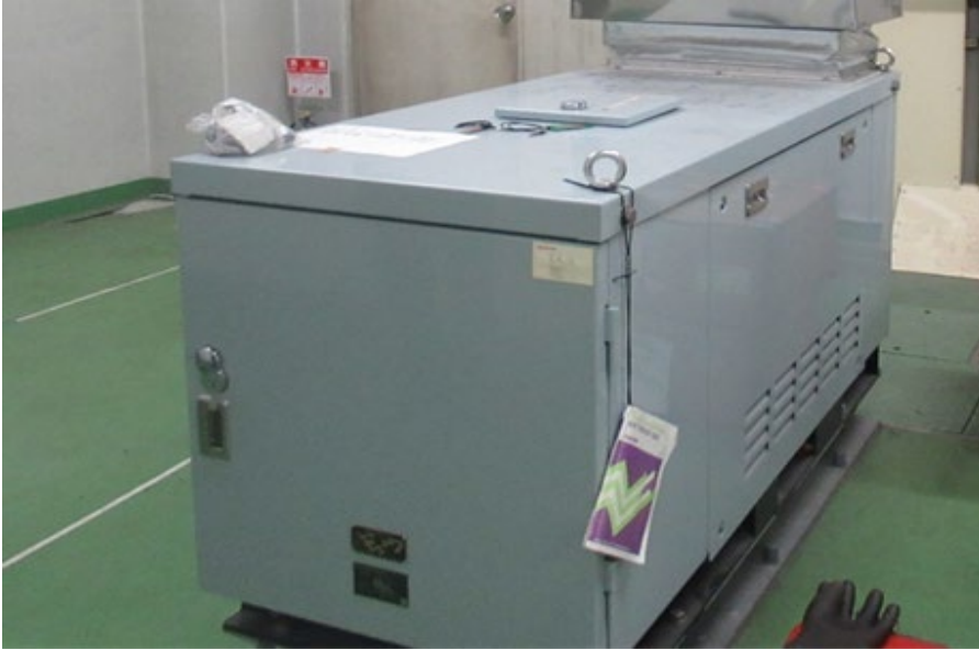
撤去予定の発電機
