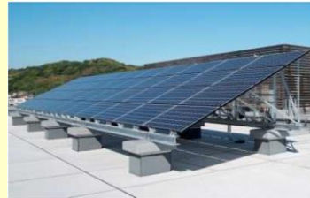
庁舎の太陽光発電設備の例
