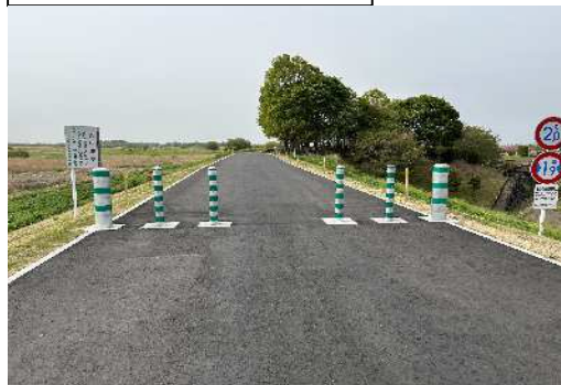
車止めの視認性が悪い
