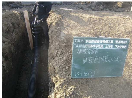
田んぼダム用水位調整管
