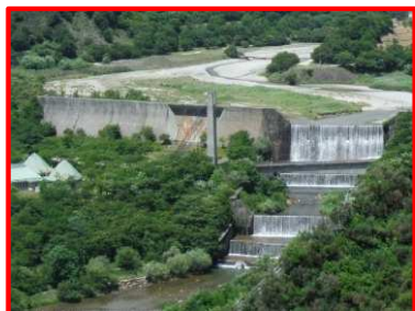
砂防施設の整備(足尾砂防堰堤)
