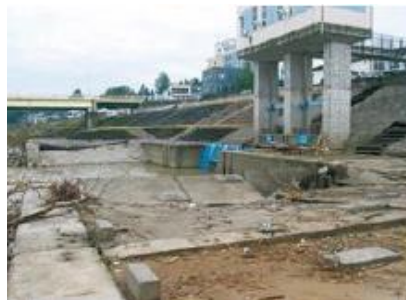
水門低水護岸の破損
