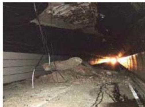
トンネルの崩落
