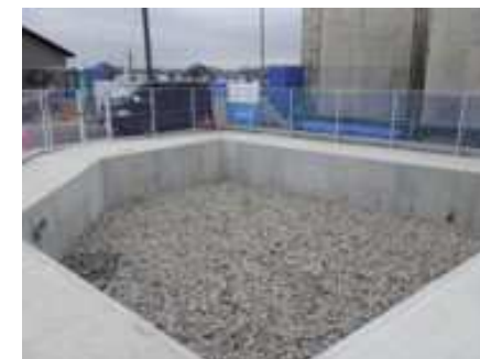
雨水貯留施設（さくら市内民間施設）
