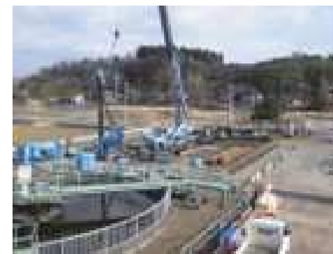
益子浄化センター耐水化整備状況
