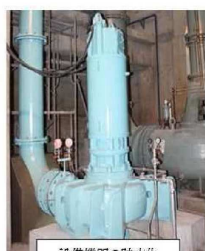
設備機器の防水化 (耐水型モーター)
