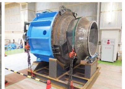
▲点検中のポンプ
