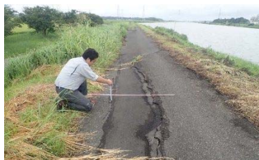
▲天端に発生した変状の計測
