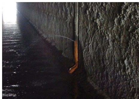
写真 6-5 函体継手部からの漏水
