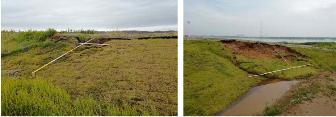
写真 6-1 堤防の法面に発生した変状
