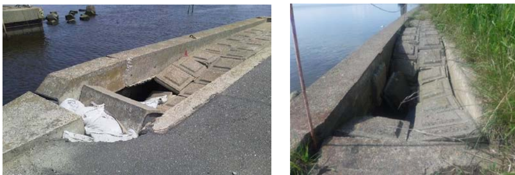
写真 6-4 護岸に発生した変状
