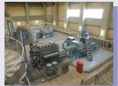
▲八潮排水機場（ポンプ設備）
