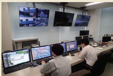
▲水門等の施設の遠隔操作
