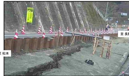
路面沈下の発生状況(R3.3.26)
