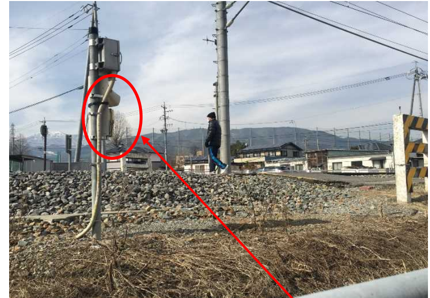
【列車接近警報機の設置】
