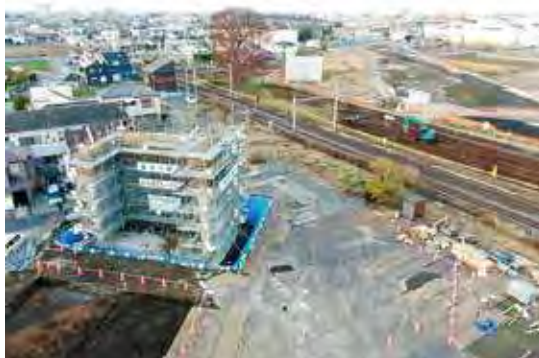
JR 高崎線交差部の橋梁下部工事の状況 (令和3年12月撮影)
