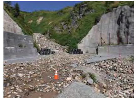
写真49-1 平成30(2018)年9月、台風21号の大雨で発生した土石流で、土砂にうまった国道292号(草津町振子沢)
