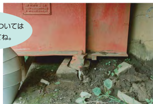
写真 100-3 変形してこわれた橋の一部 (橋床の支承部)
