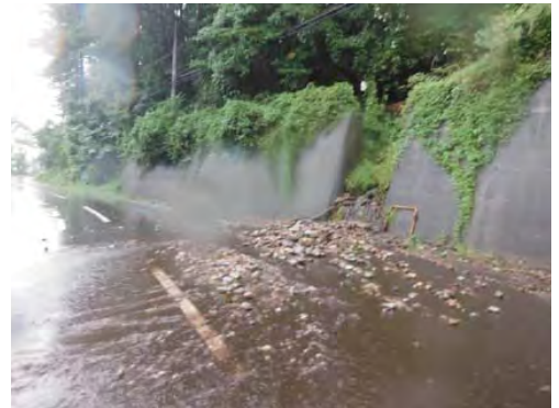
写真95-1 平成25（2013）年9月16日台風18号による大雨で発生したがけ崩れ 道路わきのがけが崩れ、車の通行ができなくなりました。
