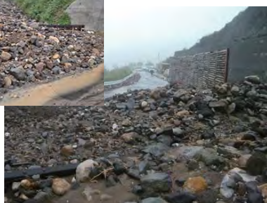
写真98-1, 98-2 平成25年9月16日台風18号で発生した土石流による道路被害（国道292号、振子沢）
