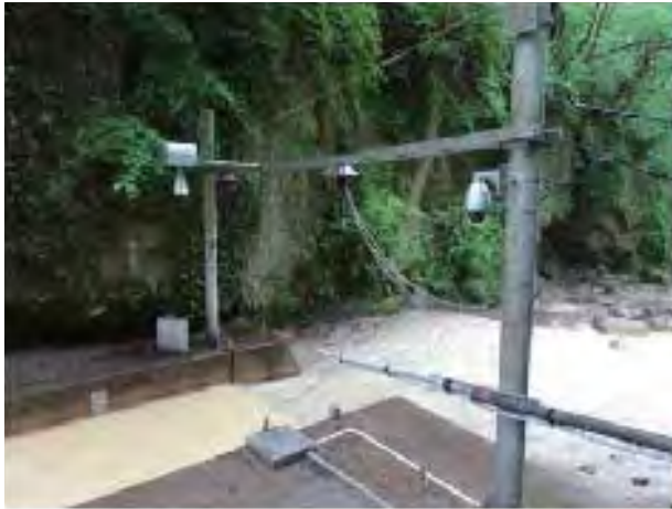
写真111-1 大沢川(六合地区入山)に整備された水位計
