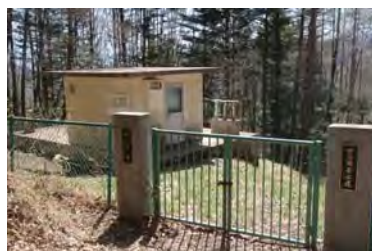
写真85-2 六合地区の簡易水道の施設
