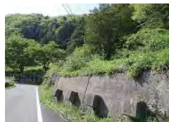
写真108-3 和光原地区の地すべり防止施設（アンカー工）
