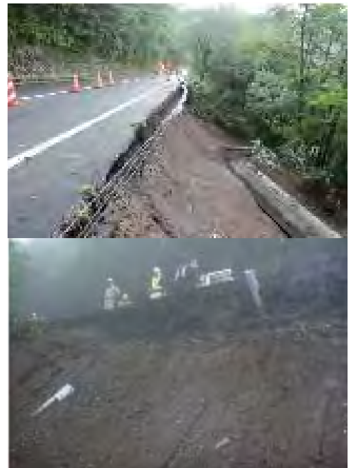
写真95-2 平成29年8月6日～9日台風5号によって国道292号の路肩が崩れたようす (中之条土木事務所)
