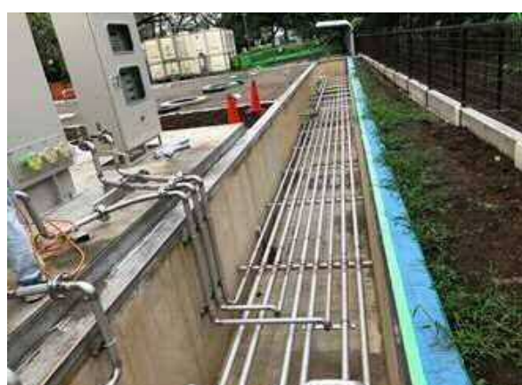
燃料配管設置状況
