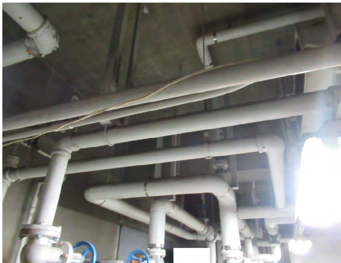
【1階機械室 天井配管】
