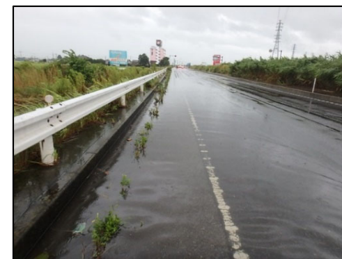
【台風時の雨水滞留状況】
