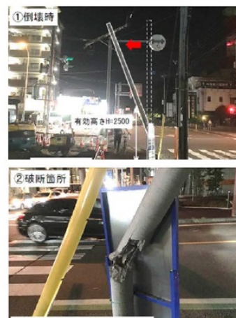
事故発生状況写真
