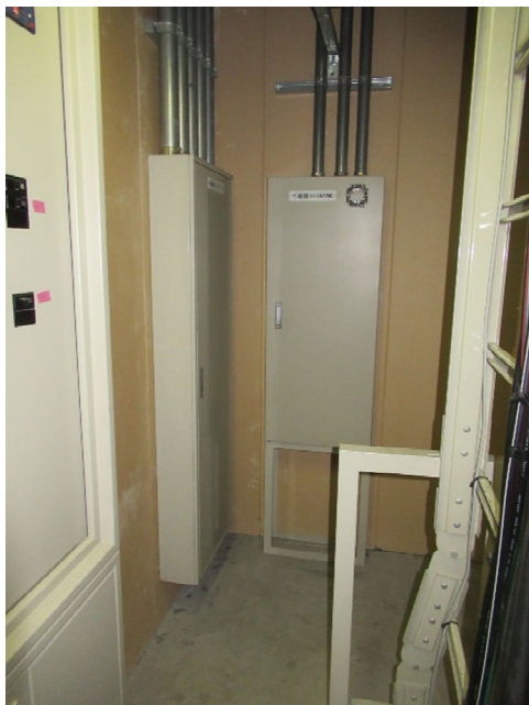
【高層棟1階EPS(4)】 防災分散処理盤
