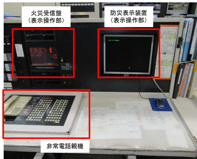
【高層棟1階防災センター】 防災監視卓(防災表示装置、非常電話親機)
