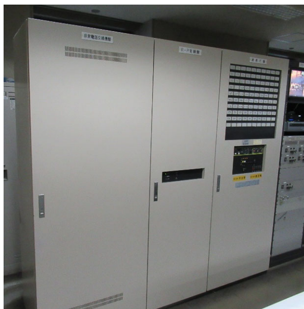
【高層棟1階防災センター】 非常電話盤、RP変換盤、諸表示盤
