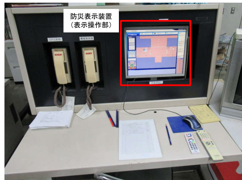
【高層棟地下3階防災センター】 副防災監視卓(防災表示装置)
