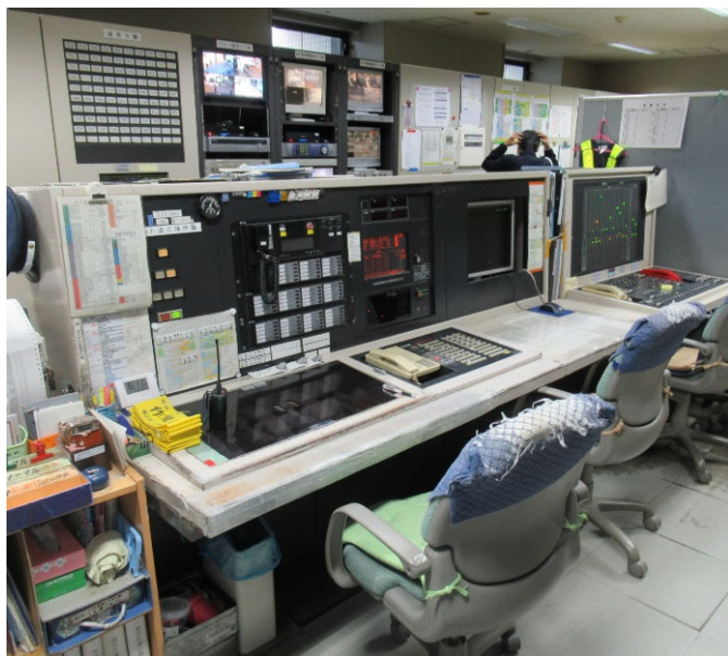
【高層棟1階防災センター】 防災監視卓
