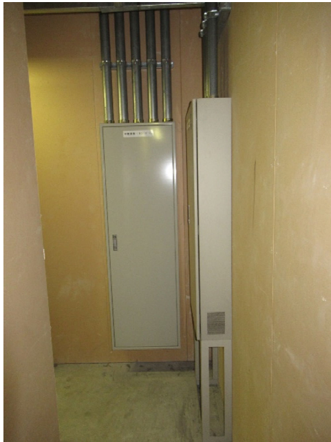
【高層棟1階EPS(4)】 中継器盤
