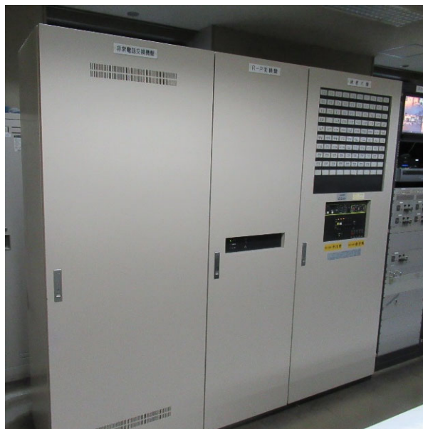
【高層棟1階防災センター】 非常電話盤、RP変換盤、諸表示盤
