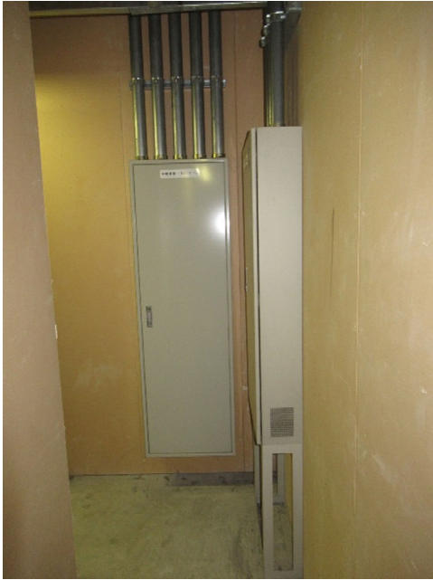
【高層棟1階EPS(4) 中継器盤
