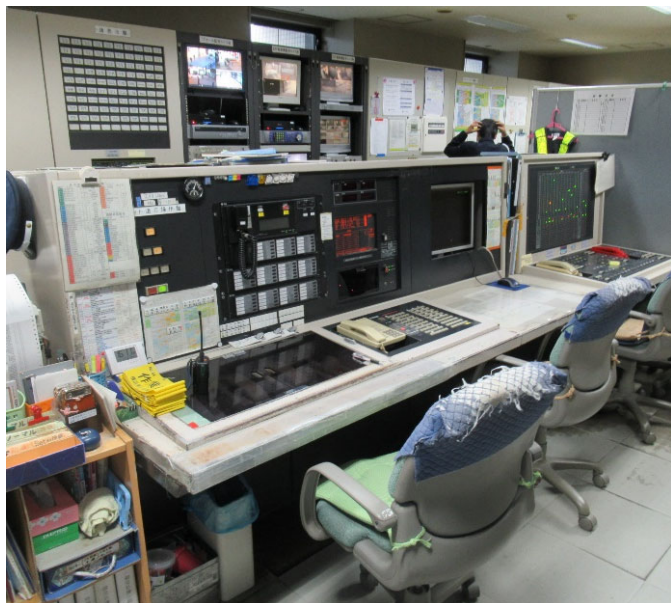
【高層棟1階防災センター】 防災監視卓
