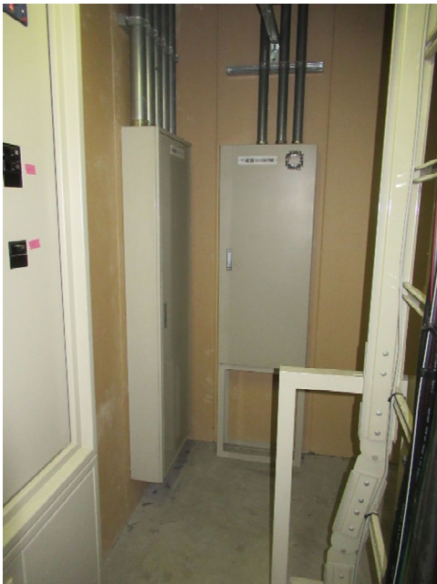
【高層棟1階EPS(4) 防災分散処理盤
