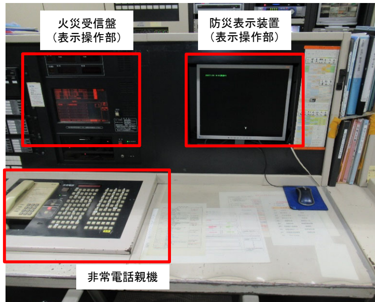
【高層棟1階防災センター】 防災監視卓(防災表示装置、非常電話親機)
