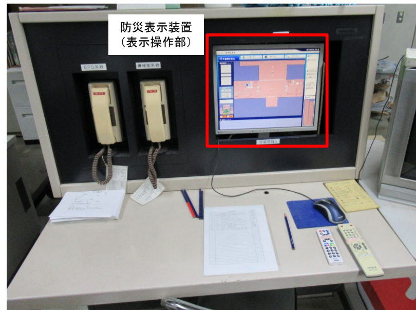
【高層棟地下3階防災センター】 副防災監視卓(防災表示装置)
