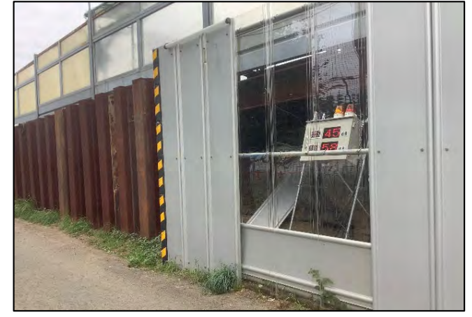
<国道1号藤沢バイパス法面における設置状況>
