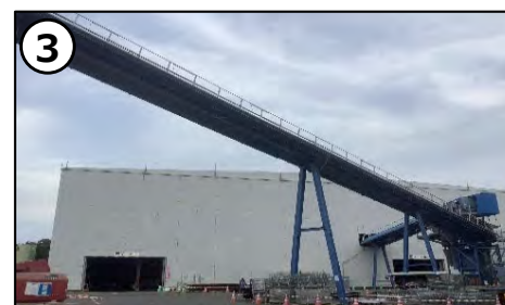
③-1 発進立坑地上設備(R4.10時点)
