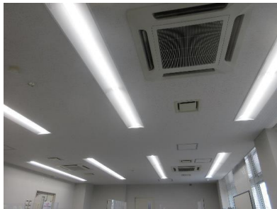
既設空調・換気設備(室内)
