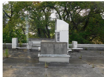
既設空調室外機(屋上)
