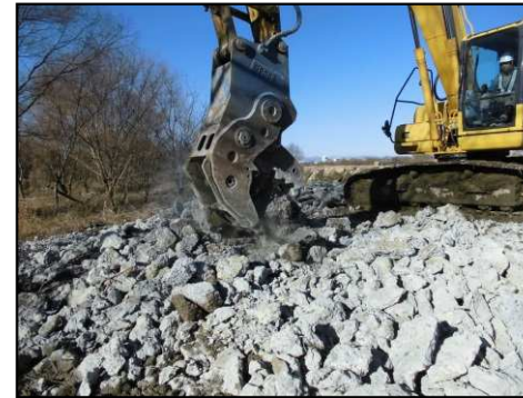
根固めブロック(2t)破碎状況
