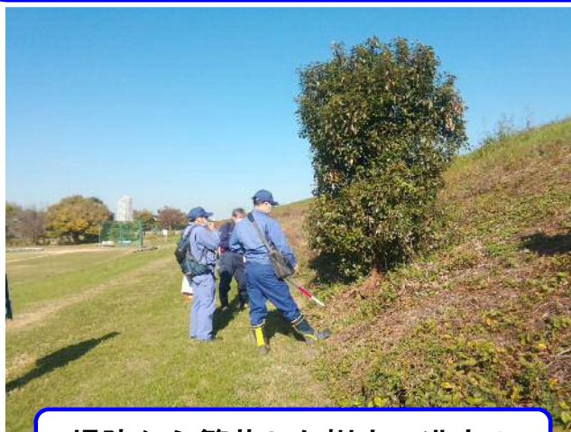
堤防から繁茂した樹木→洪水の妨げになり、堤防を痛めます
