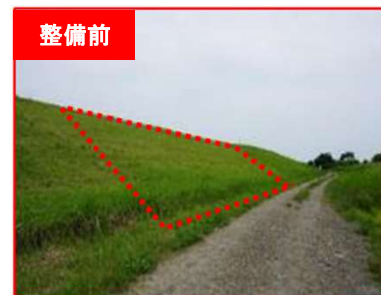
堤防の斜面が利用しにくい
