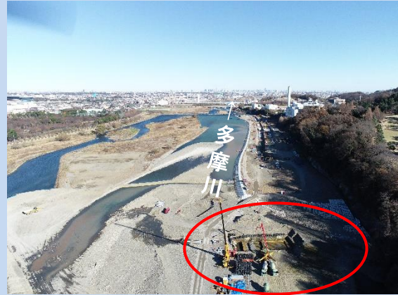
取水施設を設置しています。 (令和4年12月)
