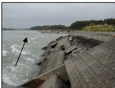
渡良瀬川の護岸被災状況(太田市)
