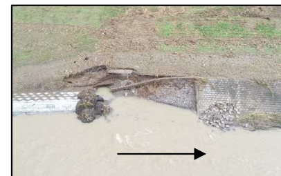
支川秋山川の護岸被災状況(佐野市)
