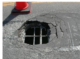
【道路が損傷した例】
