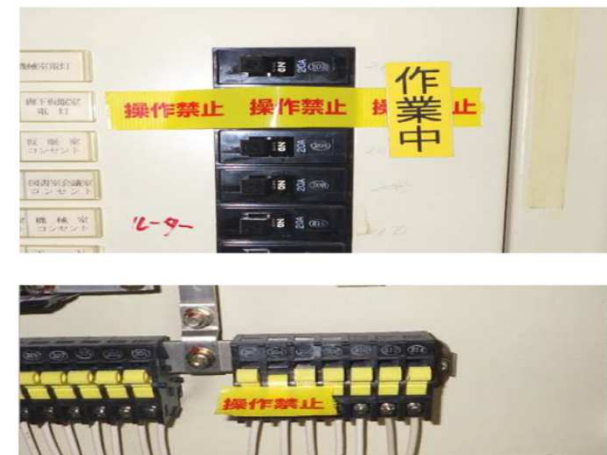
ステッカーによる操作禁止の明示
