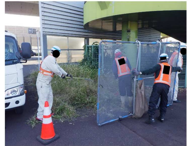
飛散防止ネットの使用
