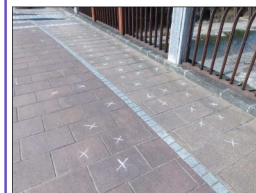
〔橋面タイルの浮き〕
