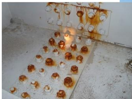
箱桁内のボルト部の腐食
