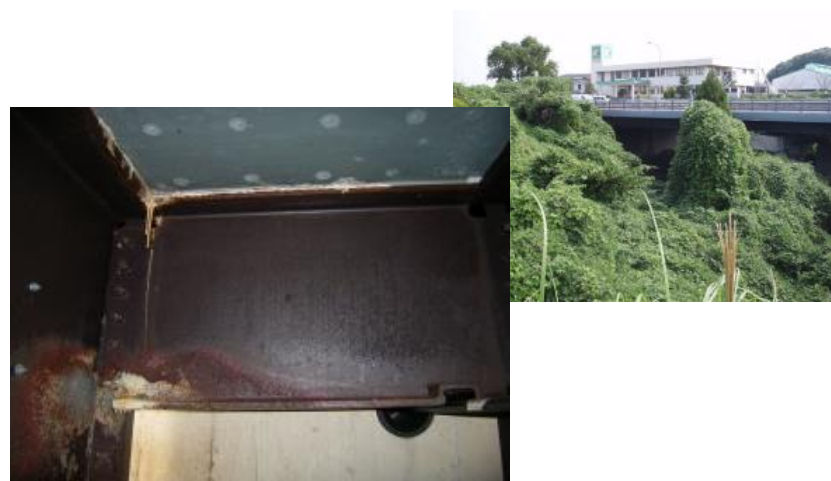
床版からの遊離石灰の析出
