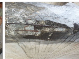
〔アーチリブの剝離・鉄筋露出〕
