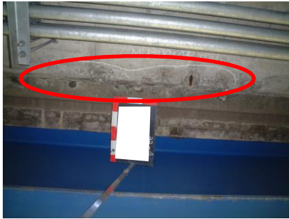
主桁の剥離・鉄筋露出
