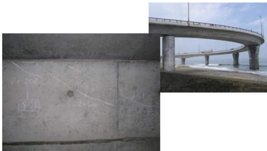
箱桁ウェブ面のひびわれ
