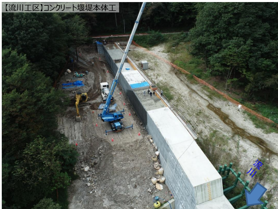
【流川工区】コンクリート堰堤本体工 下流側より右岸撮影
