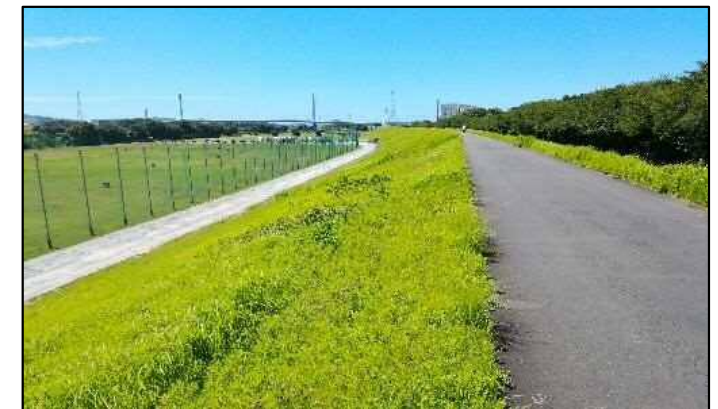
堤防の斜面が利用しにくい
