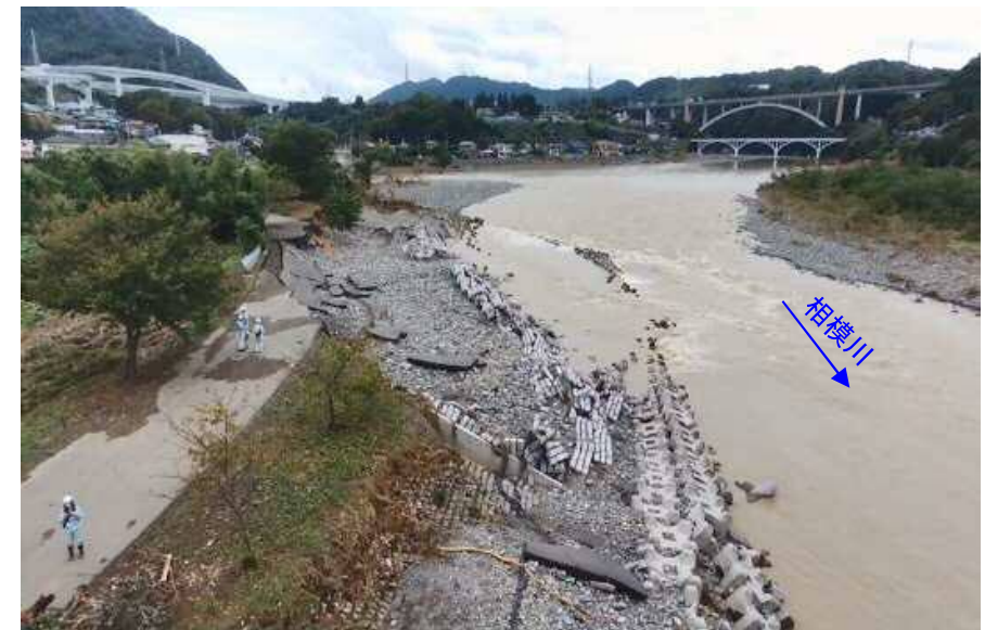
▲令和元年東日本台風による護岸被災状況 （相模原市緑区大島）
