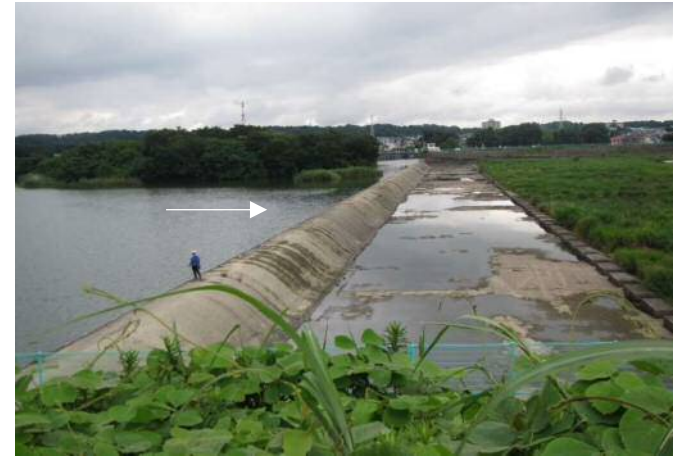
▲改築に向け関係機関と調整を進めている磯部頭首工
