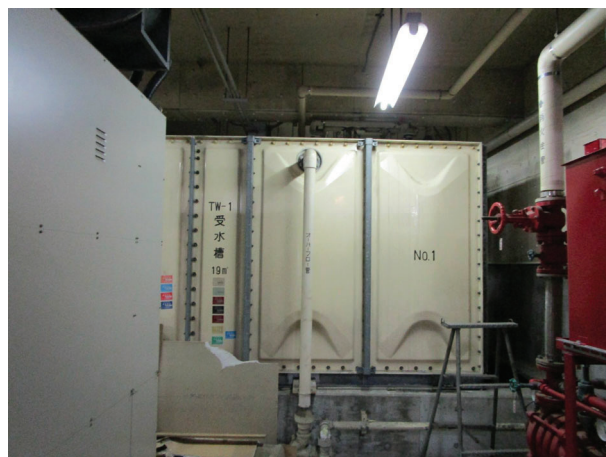
⑥1F機械室受水槽
