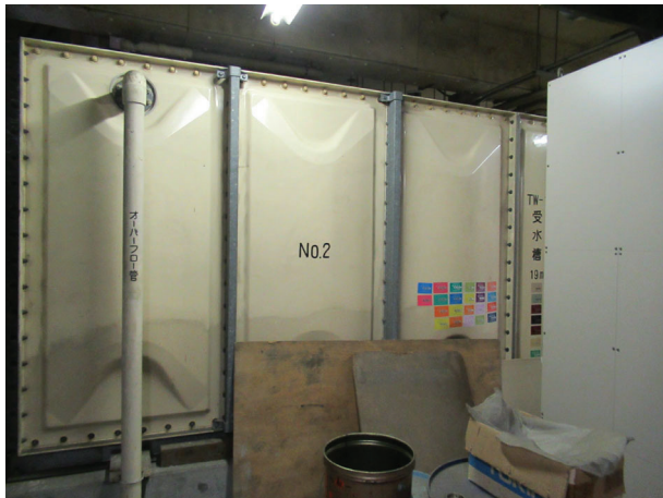
⑦1F機械室受水槽
