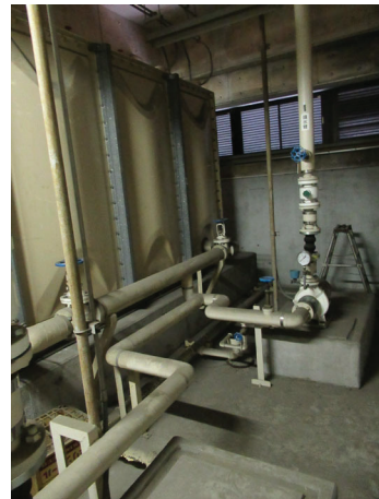
⑧1F機械室受水槽
