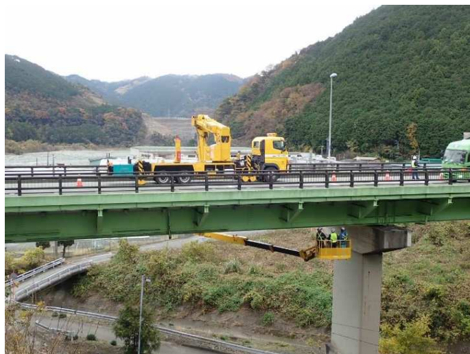
橋梁点検車による点検のイメージ写真 写真は山梨県内国道の昼間点検時の写真です。
