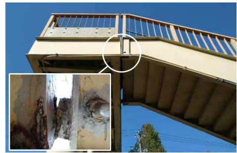
図-2 破断した階段桁のフック
