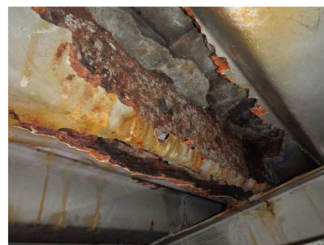
写真-3 広範囲に鋼板が喪失した床版
