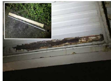
図-4 補修材が落下した床版
