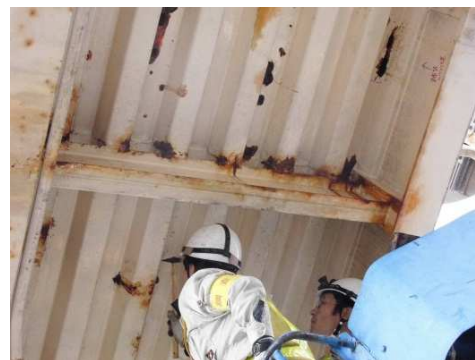
写真-1 床版(波型鋼板)の孔食
