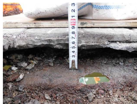
写真-2 充填コンクリートが喪失した舗装下
