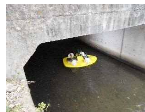
水上ドローンによる損傷把握
