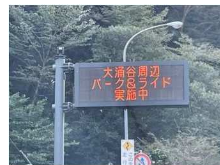
横浜国道事務所管轄情報板 【箱根新道山崎旧料金所付近】
